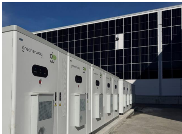
Bilde: nyinstallerte batterier på Toveien 28
